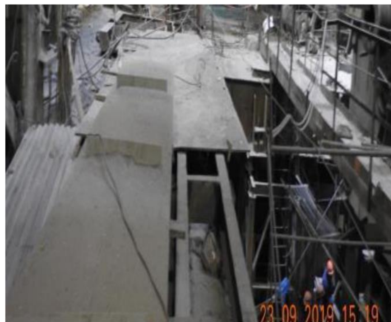
Отсутствует ограждение перепада по высоте
